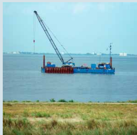
Parallel zu den Arbeiten auf der Startseite wurde das Einleitbauwerk mit der genau zu treffenden Zielöffnung gebaut.
